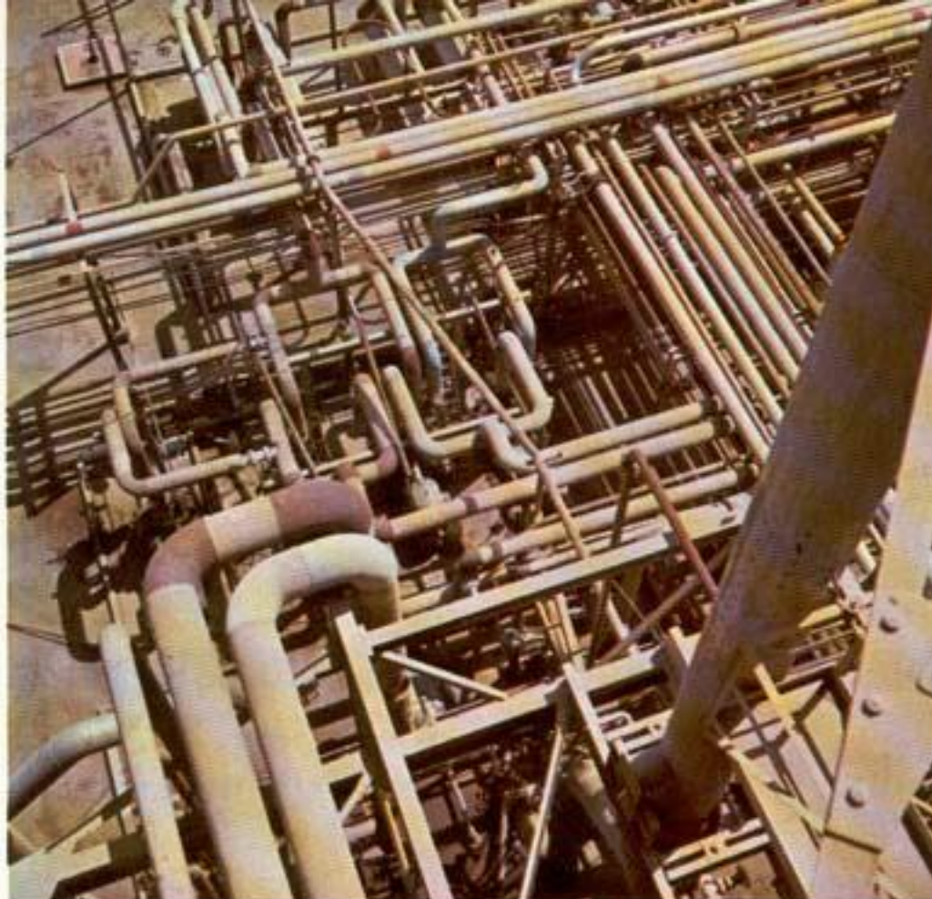
Complejo e intrincado conjunto de tuberías en esta vista parcial de la refinería La Pampilla.
